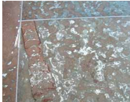
Fig 3.29 Saltvittring i kalkstensgolv.
