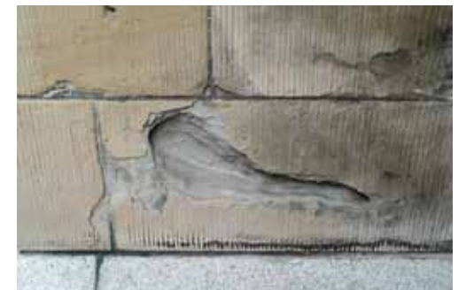
Fig 3.20 Exfolieringsskador, Gotlandssandsten(karbonatbunden). Tyska kyrkan, Stockholm
